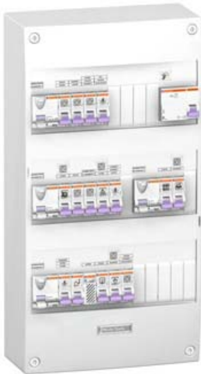
Installation dans un coffret Opale 3 rangées
