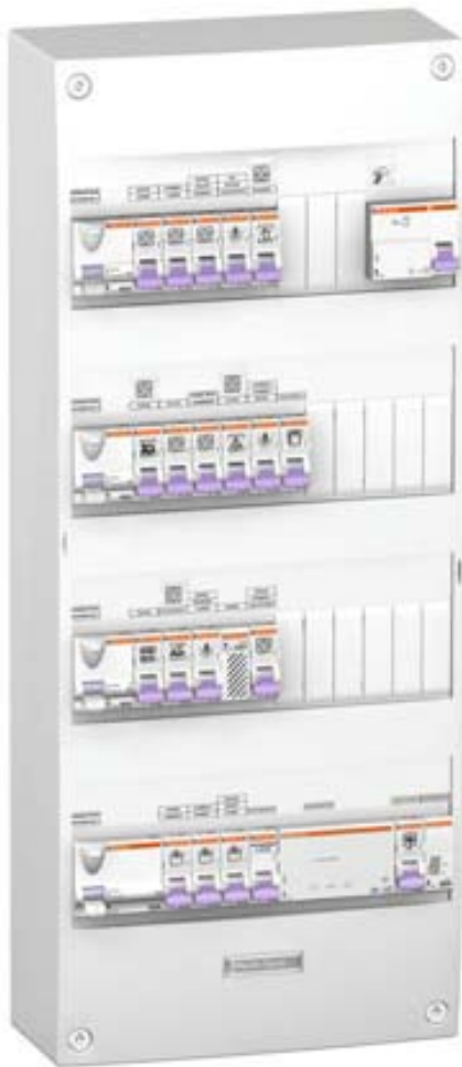
Installation dans un coffret Opale 3 rangées
